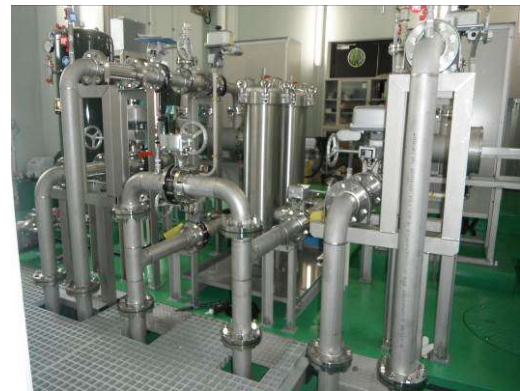
▲ 紫外線照射装置（升田水源地）
