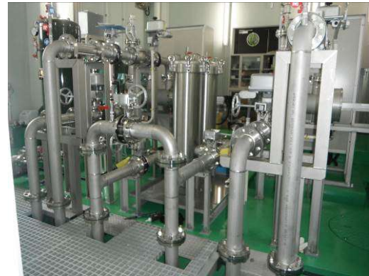
▲ 紫外線照射装置（升田水源地）
